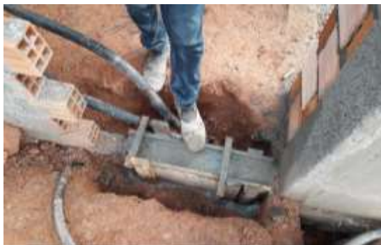
Figura 4 – Incompatibilidades entre projetos estrutural e elétrico (viga baldrame)
