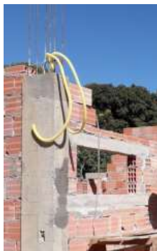
Figura 3 – Incompatibilidades entre projetos estrutural e elétrico (pilar)
