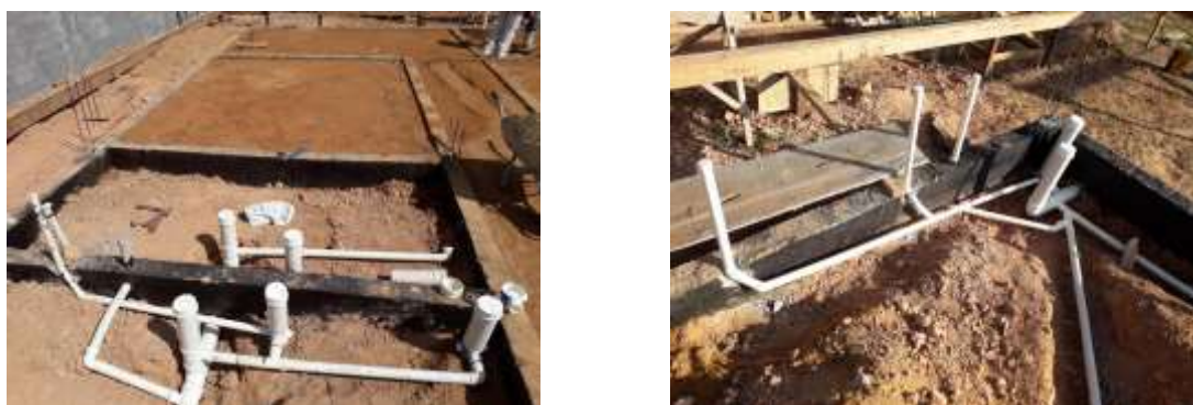
Figura 1 – Incompatibilidades entre projetos estrutural e sanitário
