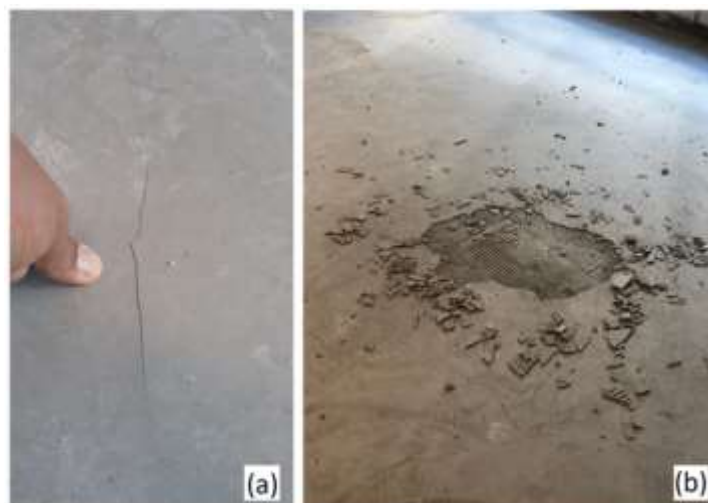
Figura 3 - (a) Fissura no piso, (b) Desagregação da camada de regularização
